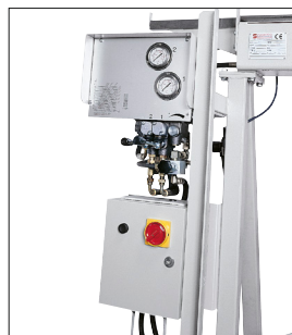
Détail du tableau de commandes.
